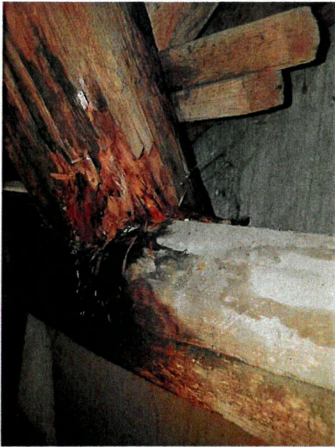
Eindringendes Wasser bei Kehle zum Turm
